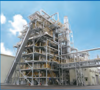
バイオマス発電プラント
