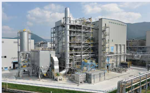
バイオマス発電ボイラ
