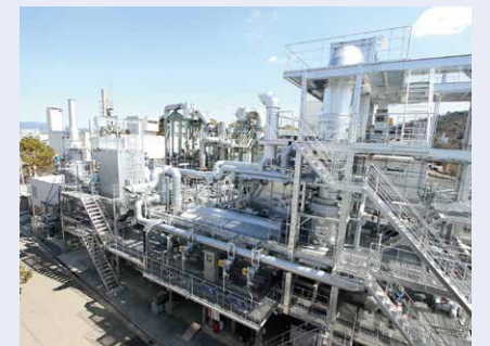
下水汚泥焼却発電プラント
