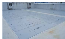
移床式上向流連続砂ろ過装置(高速型) 処理量:29,500m 3 /日
