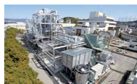
汚泥焼却発電システム実証プラント 処理量:35t-wet/日(含水率約70%) 発電量:約100kWh/h
