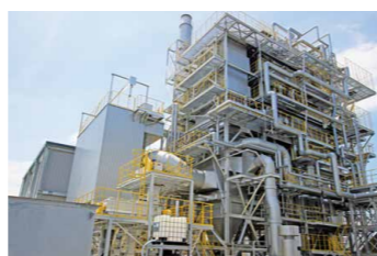
バイオマス発電プラント
