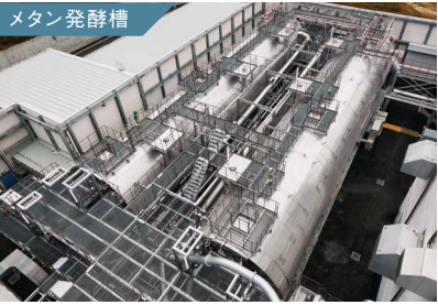
メタン発酵槽
