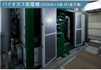
バイオガス発電機（250kW×4基 内1基予備）
