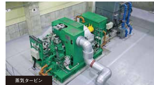
蒸気タービン
