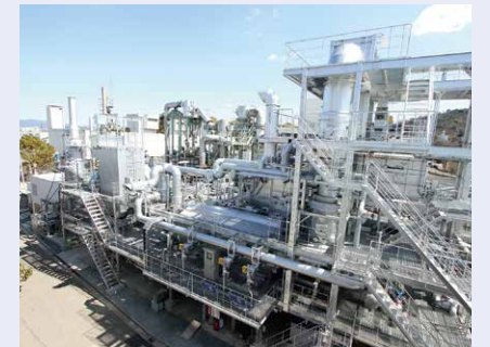
下水汚泥焼却発電プラント
