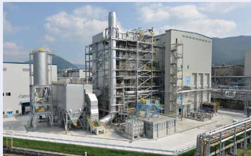
バイオマス発電ボイラ
