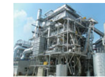
鶏ふん焼きボイラ
