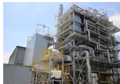
バイオマス発電プラント
