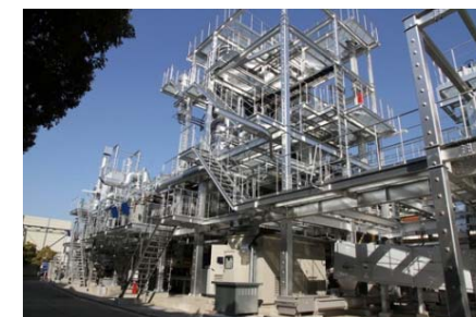
下水汚泥焼却発電システム
