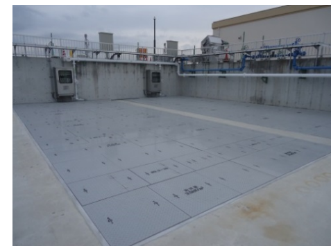
移床式上向流連続砂ろ過装置（高速型） 処理量：29,500m 3 /日
