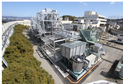
汚泥焼却発電システム実証プラント 処理量：35 t-wet/日（含水率約70%） 発電量：約100kWh/h
