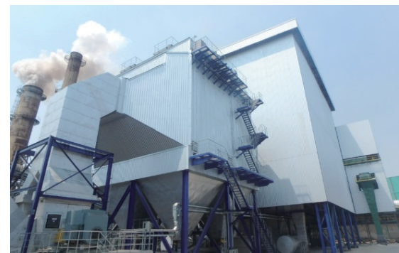
バガス燃焼ボイラプラント（タイ）
