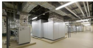
給排水衛生設備
