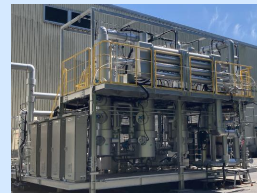
CO 2 の分離回収を行う実証装置
