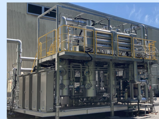
CO 2 の分離回収を行う実証装置(真庭バイオマス発電所)
