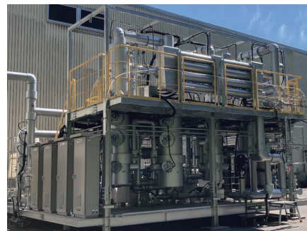
CO 2 の分離回収を行う実証装置
