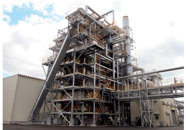
バイオマス発電プラント
