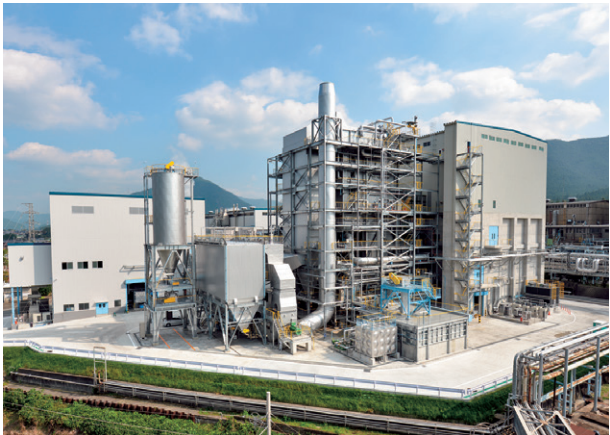
バイオマス発電プラント
