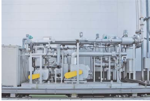
図3 燃焼ガス浄化設備外観
