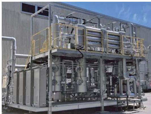
図3 CO 2 分離回収試験装置外観
